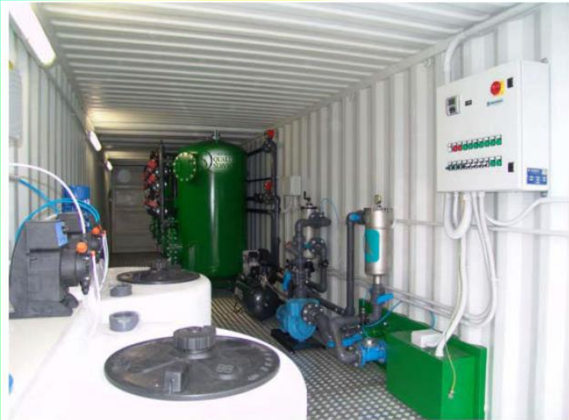
Vista interior de la planta
